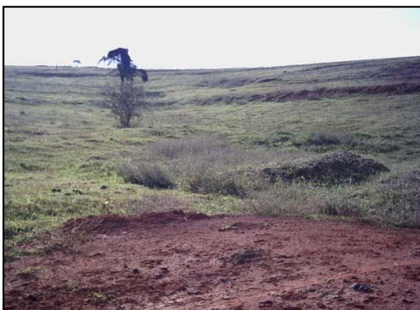
Fig. 7: Canal de escoamento pluvial que representa risco de erosão e degradação da mata localizada à jusante. Foto: Salvador Carpi Jr, 14/07/2009
