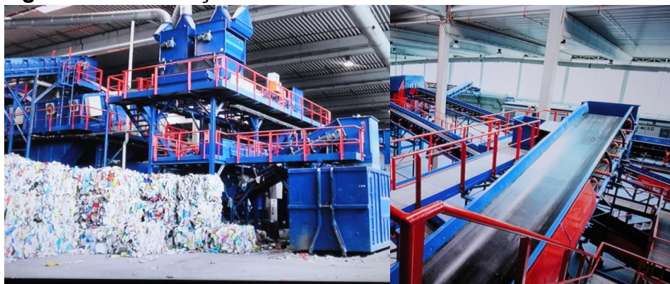
Figura 20 – Instalações do CTR do Vale Ocidental de Barcelona
