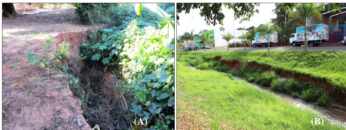
Figura 7. (A) Solapamento de margem a poucos metros de moradia no Distrito de Simões. (B) Erosão fluvial das margens do Córrego Saltinho, Centro.
