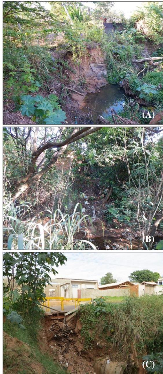
Figura 3. (A) Solapamento de margem no Setor 1. (B) Imóveis parcialmente colapsados no Setor 2. (C) Parte da rua afetada por pequeno escorregamento em margem fluvial no Setor 3.
