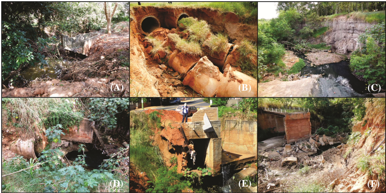
Figura 8. (A) Final de galeria com a base erodida no bairro Jardim das Palmeiras IV, Dracena. (B) Manilhas destruídas no Córrego das Palmeirinhas, Dracena. (C) Grande solapamento de margem após final de canalização do Córrego das Marrecas, Jardim Kennedy, Dracena. (D) Final de galeria erodido no Jardim Éden/Vila Lucélia, Dracena. (E) Início do processo erosivo e final da canalização do Córrego Alheiros, Parapuã. (F) Ponte colapsada pela erosão marginal do Córrego das Marrecas, bairro Fioravante, Dracena.
