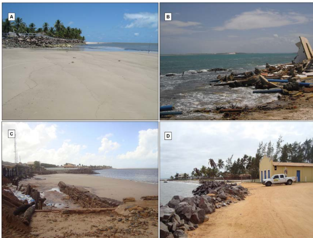
Figura 6 - Erosão costeira na praia estuarina (sul da praia do Saco). (A) Estrutura de contenção para proteção de residências (28 de outubro de 2007, maré baixa de sizígia); (B) Destroços de estruturas antrópicas (07 de novembro de 2011, maré baixa de quadratura); (C) Estrutura de contenção (espigão de rocha) em 26 de maio 2017, na maré baixa de sizígia; (D) Presença de estrutura de contenção próxima à igreja, que constitui um patrimônio histórico (26 de setembro de 2018, maré alta de sizígia). Trechos sem praia, independente da maré, em (A), (B) e (D). Para localização, (A), (B), (C) e (D) correspondem, respectivamente, aos transectos 13, 9, 15 e 10 da figura 3A. Fonte: Arquivo LACMA.
