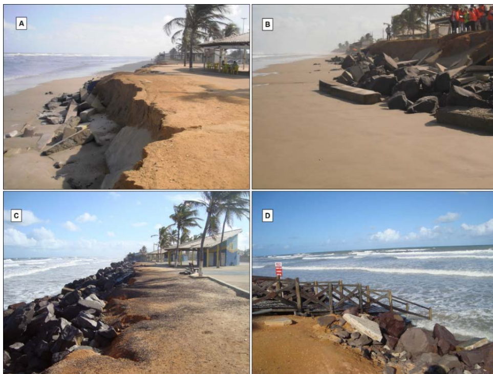
Figura 8 - Erosão costeira na praia da Caueira. (A) Escarpa erosiva no aterro e destroços de estruturas antrópicas (07 de novembro de 2011, maré baixa de quadratura); (B) Destroços de estruturas antrópicas (07 de novembro de 2011, maré baixa de quadratura); (C) Estruturas de contenção em 26 de setembro de 2018, na maré alta de sizígia; (D) Passarela de acesso à praia com placa de indicação de perigo – “não tomar banho em maré alta” (26 de setembro de 2018, maré alta de sizígia). Inexistência de pós-praia (praia seca) em (A), (B), (C) e (D). Em (C) e (D), a praia desapareceu na maré alta de sizígia. Para localização, (A), (B) e (D) correspondem ao transecto 18 e (C) ao transecto 19 da figura 3C. Fonte: Arquivo LACMA.
