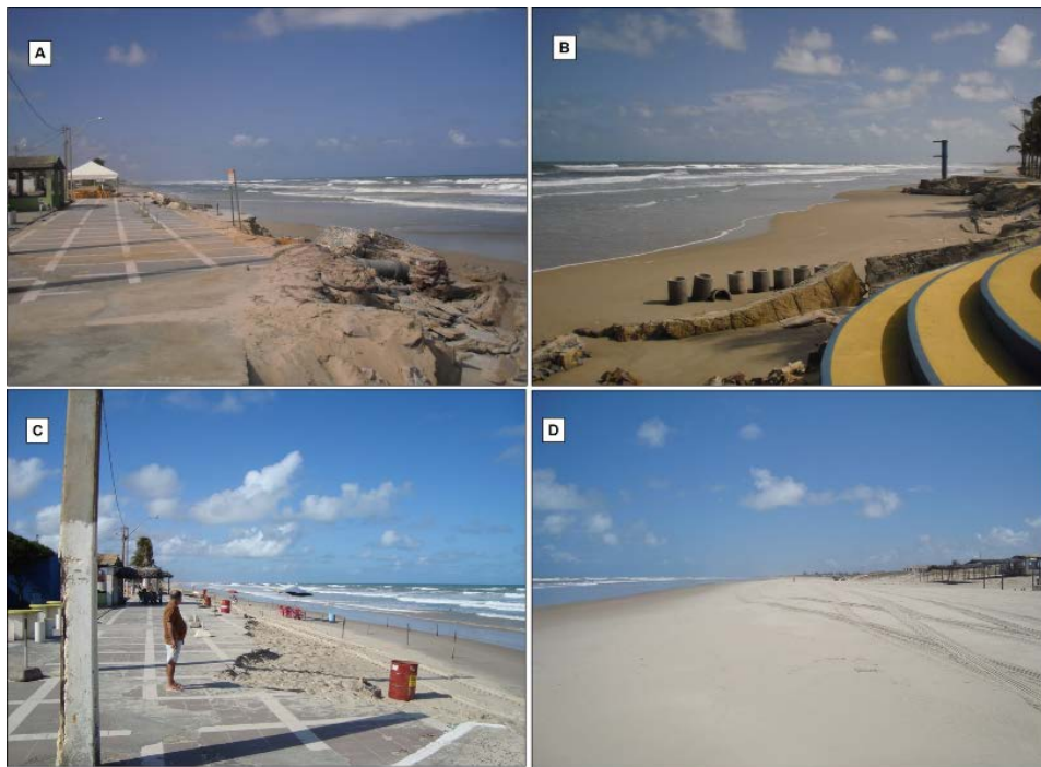
Figura 7 - Erosão costeira na praia do Abaís. (A) e (B) Estruturas antrópicas parcialmente danificadas e pós-praia (praia seca) inexistente (07 de novembro de 2011, maré baixa de quadratura); (C) Estruturas antrópicas parcialmente danificadas e pós-praia estreito (26 de setembro de 2018, maré baixa de sizígia); (D) Evidências de recuperação natural da praia mostrando pós-praia largo (26 de setembro de 2018, maré baixa de sizígia). Para localização, (A), (B), (C) e (D) correspondem, respectivamente, aos transectos 19, 18, 19 e 17 da figura 3B. Fonte: Arquivo LACMA.
