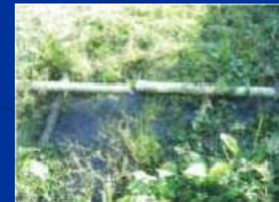
Esgoto a céu aberto
