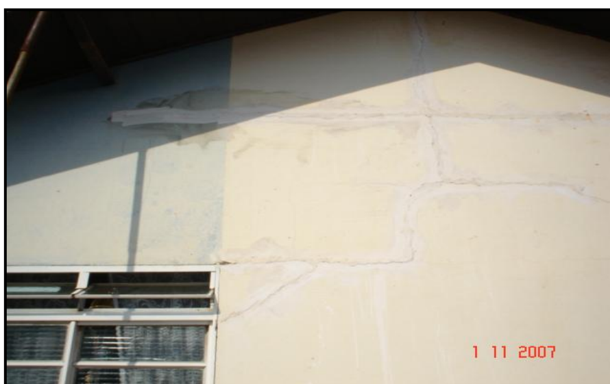
Foto 02 – Rachaduras em casa construída em voçoroca aterrada. Fonte: Vitor Hiroshi Shintani, Nov/ 2007.
